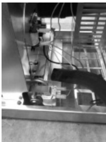
Fig. 83 - Nettoyage de le ventilateur ambiant
