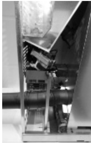
Fig. 57 - Sortie de fumées postérieure Sharp
