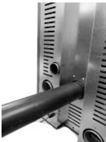
Fig. 51 - Le conduit d'évacuation
